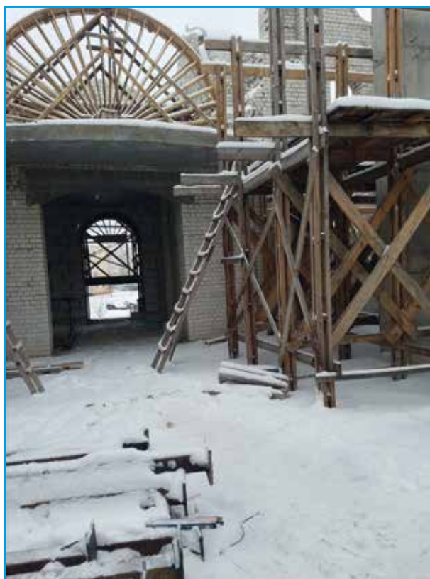
Подъем на леса по деревянной лестнице сбитой гвоздями. Отсутствует ограждение перепадов по высоте
