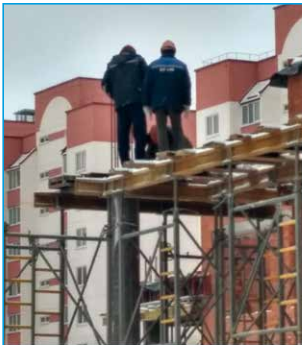
Неприменение предохранительных поясов у перепада по высоте. Отсутствие ограждения
