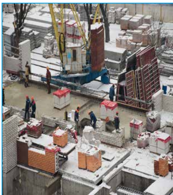
Отсутствуют ограждения перепадов по высоте
