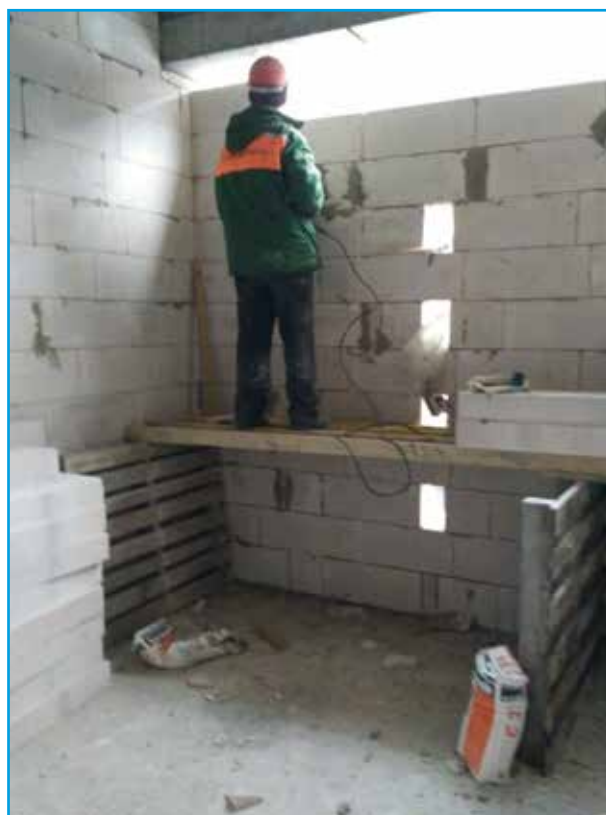
Для выполнения каменных работ применяются средства подмащивания с шириной настила менее 2 м
