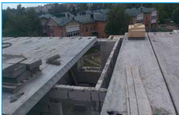
Плиты перекрытия смонтированы без предварительно выложенного из кирпича бортика на два ряда выше уровня укладываемых плит. Не выполнено ограждение перепада по высоте
