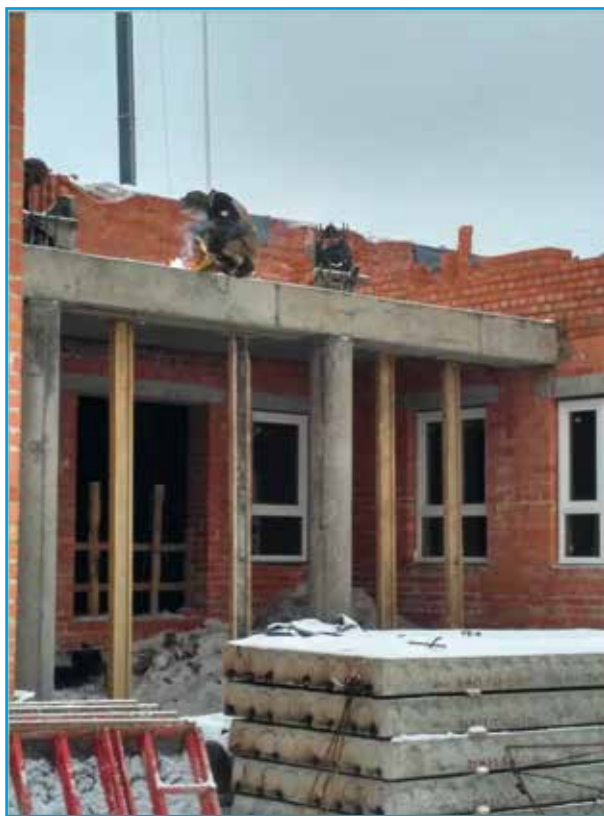
Неприменение предохранительных поясов у перепада по высоте. Отсутствие ограждения
