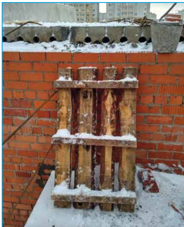
Пустоты в плитах не заделаны до их подачи к месту кладки в проектное положение. Подъем к рабочему месту осуществляется по поддонам
