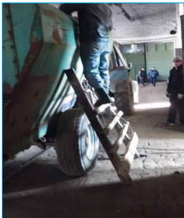
В качестве средств подмащивания при проведении сварочных работ применялась самодельная, не соответствующая требованиям безопасности деревянная решетка
